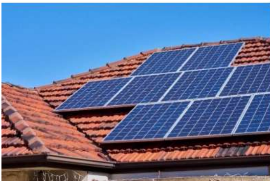
Gambar 1. Peletakan panel surya di atap gedung
